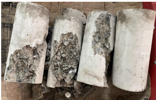
Gambar 8. Pola retak beton
